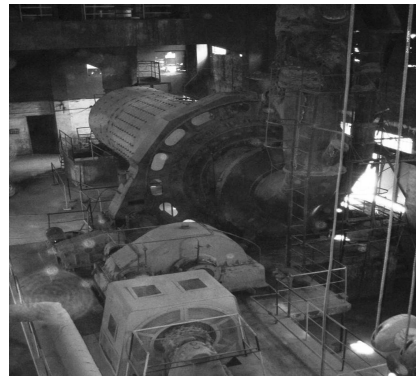
图6 磨煤机工业现场图片
